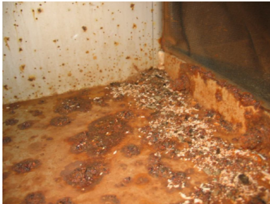
a) Rohgaskanal (Lochfraß)
